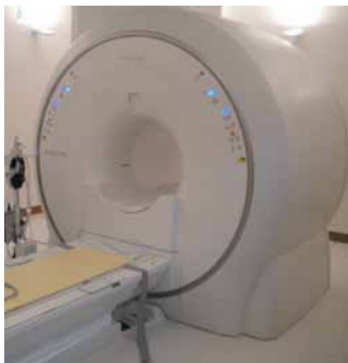
写真1 :1.5テスラ超伝導型MRI装置(第1MRI室)
